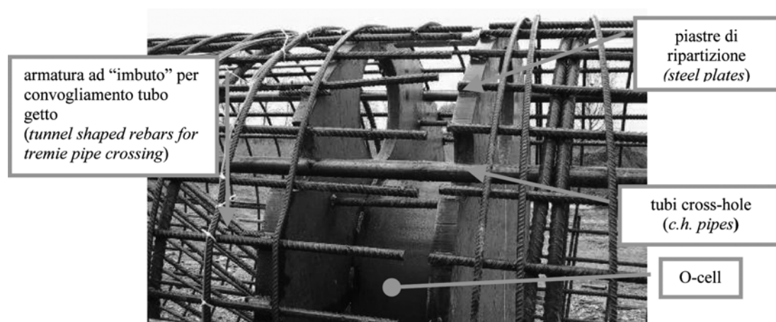
Fig. 1 – La cella Osterberg connessa alla gabbia d'armatura di un palo \varnothing 2000 mm. Fig. 1 – The Osterberg cell connected to a 2000 mm dia. bored shaft reinforcement.
